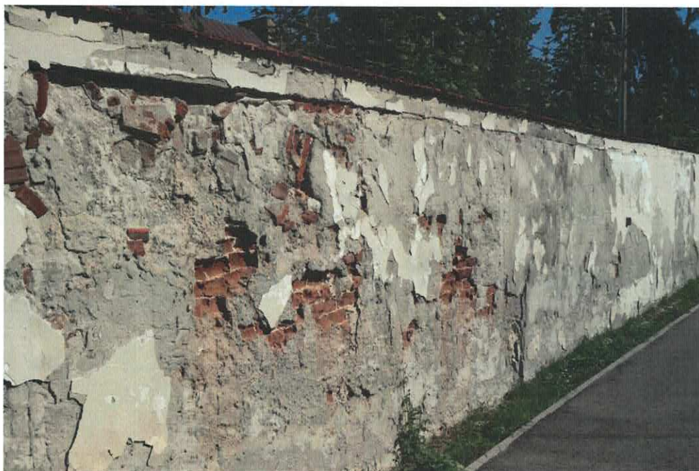
Fot. 1. Korozja mrozowa i chemiczna, widoczne znaczne procesy wietrzeniowe cegieł
