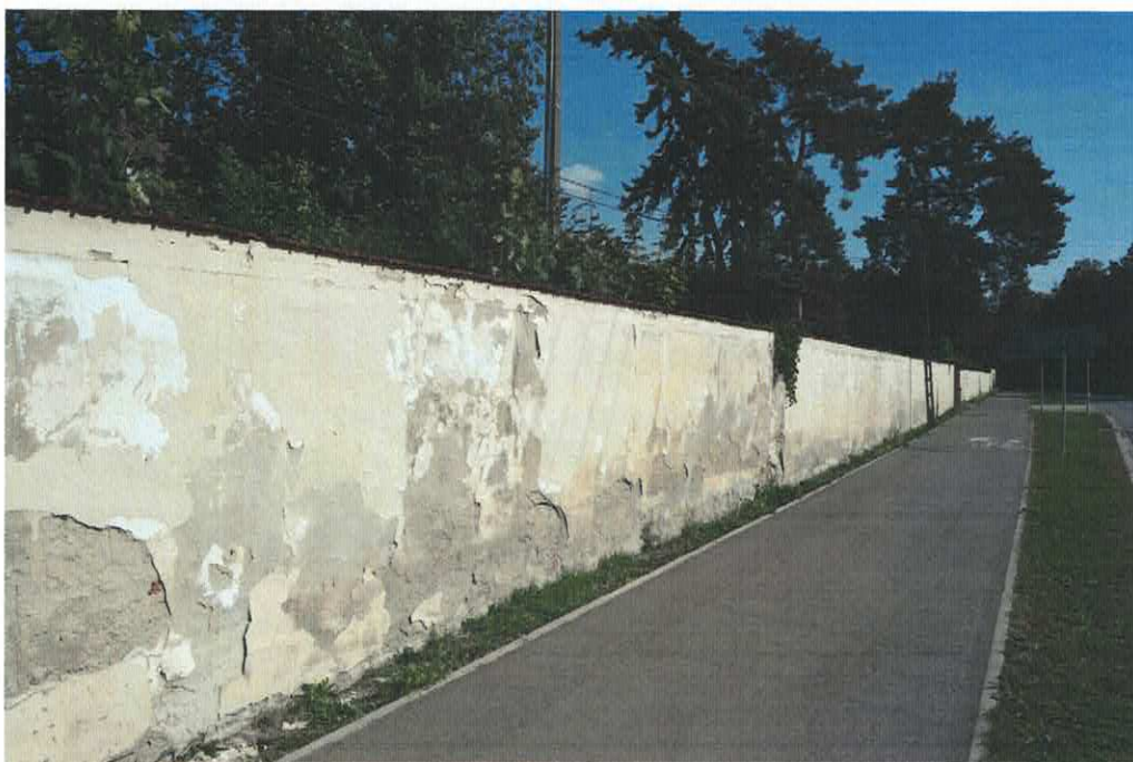
Fot. 2. Korozja mrozowa i chemiczna, widoczna krystalizacja soli i zawilgocenie
