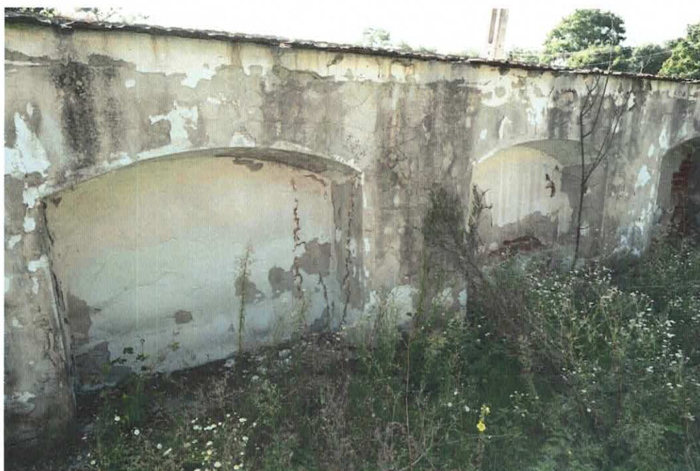
Fot. 9. Korozja mrozowa, chemiczna i biologiczna
