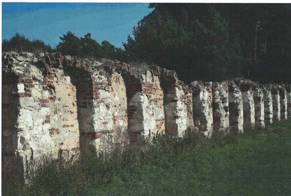
Fot. 3. Korozja mrozowa i chemiczna, widoczne znaczne procesy wietrzeniowe cegieł
