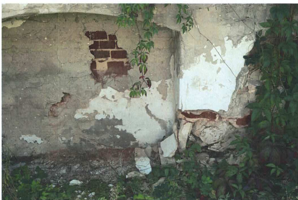
Fot. 10. Korozja mrozowa, chemiczna i biologiczna, widoczne znaczne procesy wietrzeniowe
