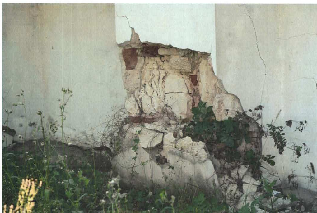
Fot. 8. Korozja mrozowa, chemiczna i biologiczna, widoczne znaczne procesy wietrzeniowe
