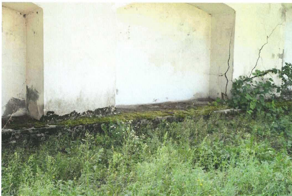
Fot. 7. Korozja mrozowa, chemiczna i biologiczna
