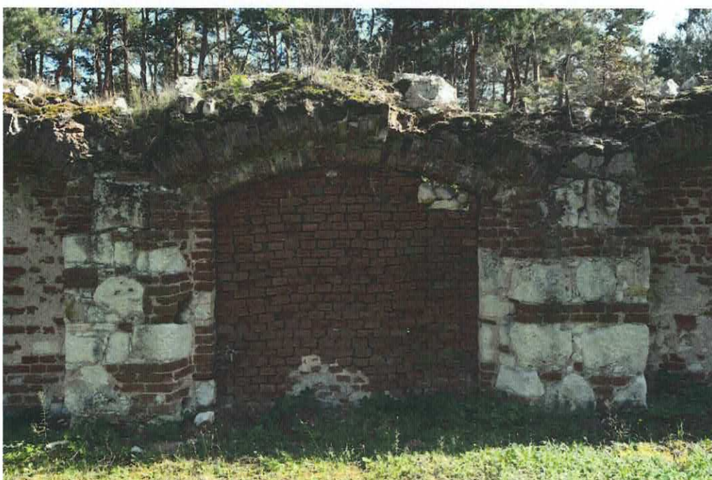
Fot. 4. Korozja mrozowa i chemiczna, widoczne znaczne procesy wietrzeniowe cegieł
