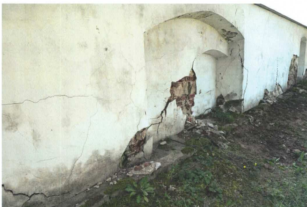
Fot. 6. Korozja mrozowa, chemiczna i biologiczna, widoczne znaczne procesy wietrzeniowe
