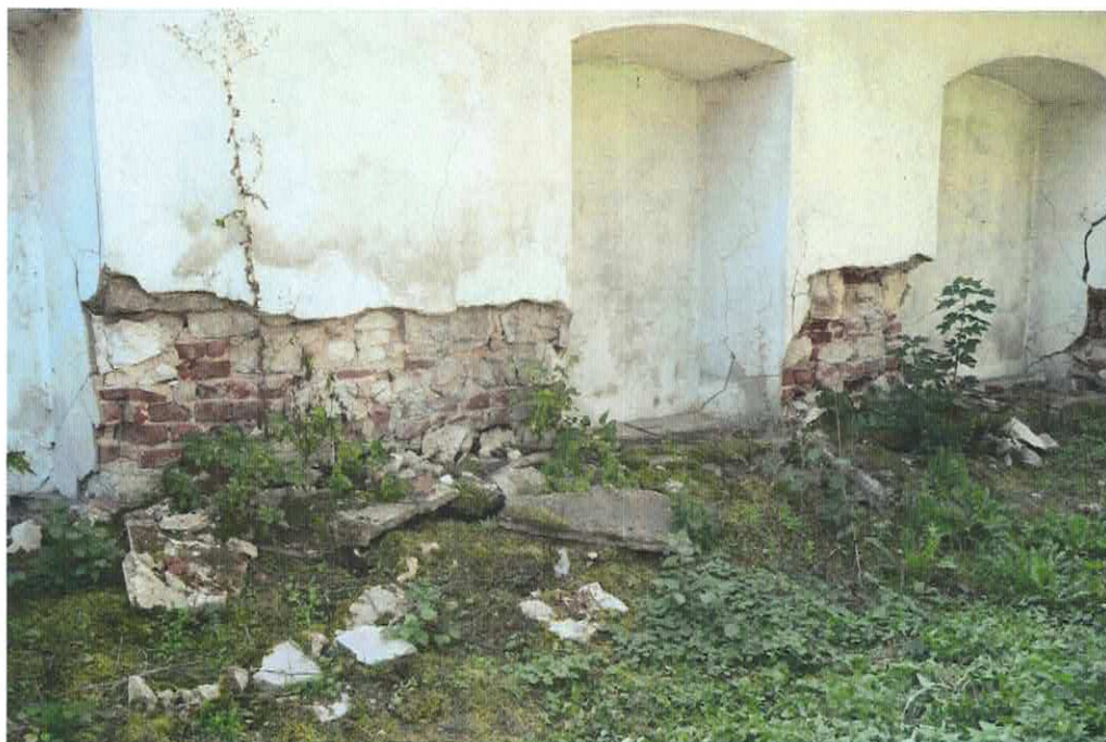
Fot. 5. Korozja mrozowa, chemiczna i biologiczna, widoczne znaczne procesy wietrzeniowe
